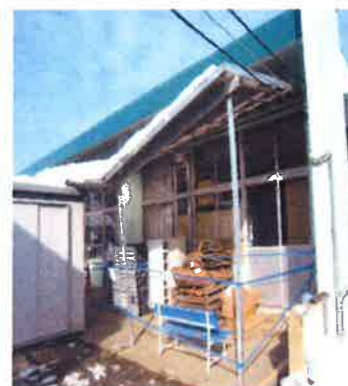
たんぼぼ作業所のテラス破損。
