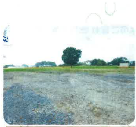
新施設の建設用地です。 皆様の深いご理解とご協力により 建設まで、あと一歩のところまで 参りました。(撮影日H29.8.7)
